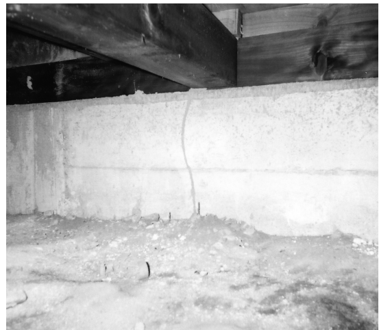
図7：住宅床下の基礎表面につくられたシロアリの蟻道(中央部)
