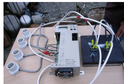
蓄電池。発電した電流をストックします。
